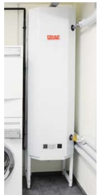
Jede Wohnung ist mit einem FRIAP Register-Schrankboiler ausgestattet.
