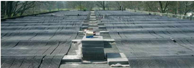
Absorberanlage auf Flachdach, Gartenbad Bachgraben, Basel
