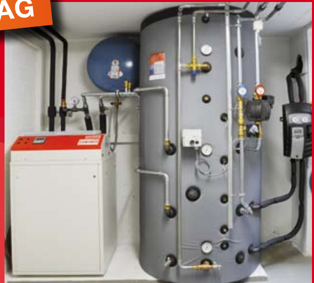
Luft/Wasser Wärmepumpe und SPIRA-WPS Kombispeicher
