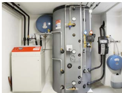
Luft/Wasser-Wärmepumpe FLWsp1-8 mit Kombispeicher TopSol 950 Liter.
