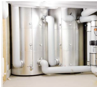
FEURON-Energiespeicher mit je 4'000 Litern Fassungsvermögen
