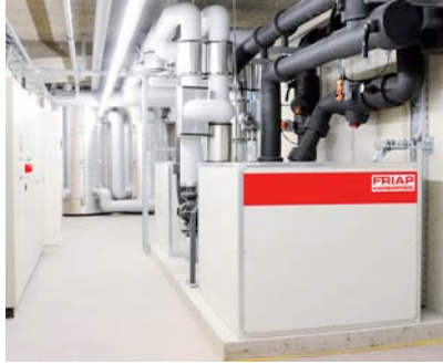
FRIAP Wasser/Wasser-Wärmepumpen mit je 180 kW Heizleistung
