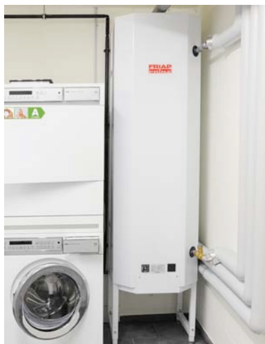
FRIAP-Register-Schrankboiler 300 Liter ohne Elektro-Heizeinsatz in jeder Wohnung installiert.
