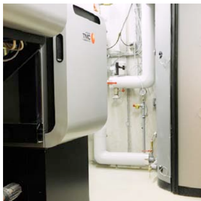
Pelletheizung 55 kW und 1100-Liter-Speicher
