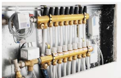
Heizungsverteiler mit Umstellventil (Heizen / Warmwasser) und Wärmezähler
