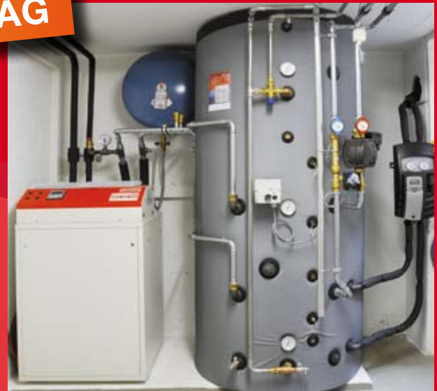
Luft/Wasser Wärmepumpe und SPIRA-WPS Kombispeicher
