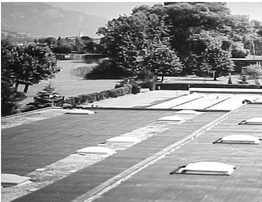
Schwimmbadkollektor auf Flachdach
